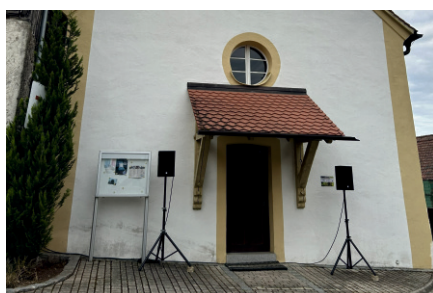
Lautsprecheranlage, KBV Riegelstein; Foto: H. Schmidt
